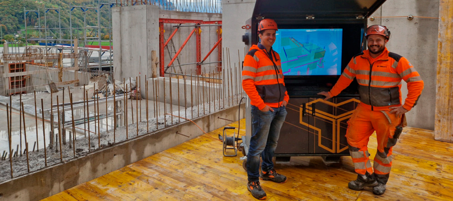
Marcel Keller, Bauführer (l.) und Christian Schuler, Polier von der Toneatti AG beim digitalen Planhaus auf der Baustelle
